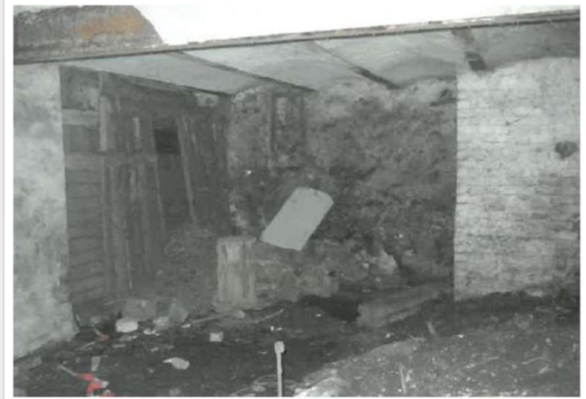
Ebenfalls dringend sanierungsbedürftig: Treppenhaus und Keller.
